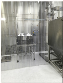
Sistema di svuotamento sacchi manuale collegato ad un sistema di trasferimento polvere
